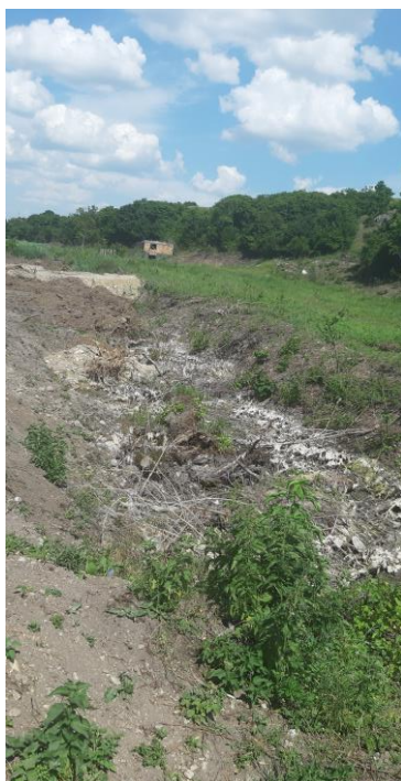
Az árok nem szállít vizet a nyugati 150 fm hosszú szakaszon (saját fotó)
